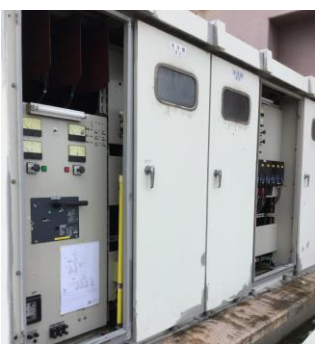
キュービクル扉破損 (暴風)
