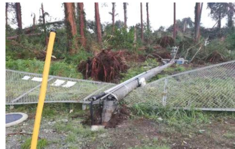
構内柱倒壊 (暴風・倒木)
