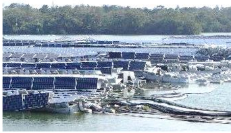
太陽光発電設備崩壊 (暴風)
